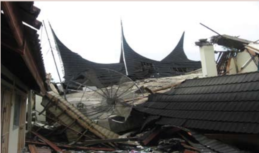
Hancurnya Bangunan Layanan Perpustakaan Badan Perpustakaan dan Kearsipan Provinsi Sumatera Barat Akibat Gempa 30 September 2009
