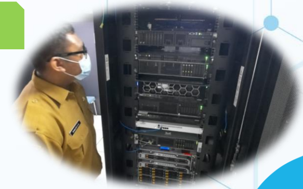
SERVER TERINTEGRASI DI DATA CENTER DISKOMINFO JABAR
