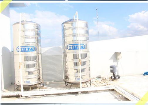
Mesin dan tangki penampungan air masing-masing kapasitas 2000 liter rooftop, Aceh Besar, Februari 2020
